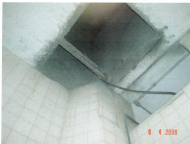
Figura 20 - Shaft do exaustor da área de Pintura
